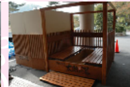
木製のセットを建て、水槽周りにベンチ・スノコを設置
